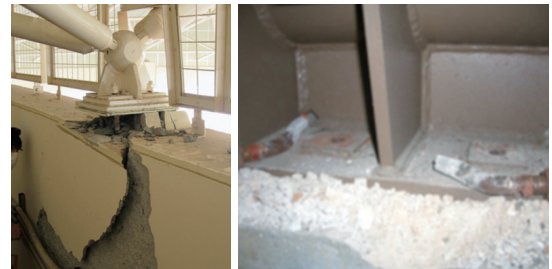
写真1、東日本大震災に損傷した接合部の例
