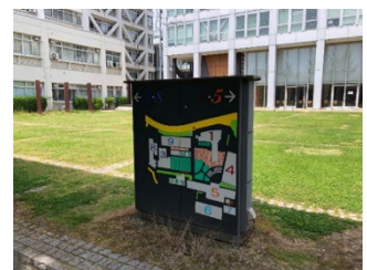
図2 八木山キャンパス中庭に設置されているシステム格納庫
