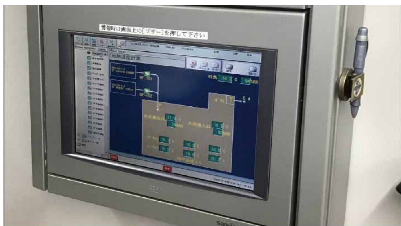
大学建物の中央監視装置
