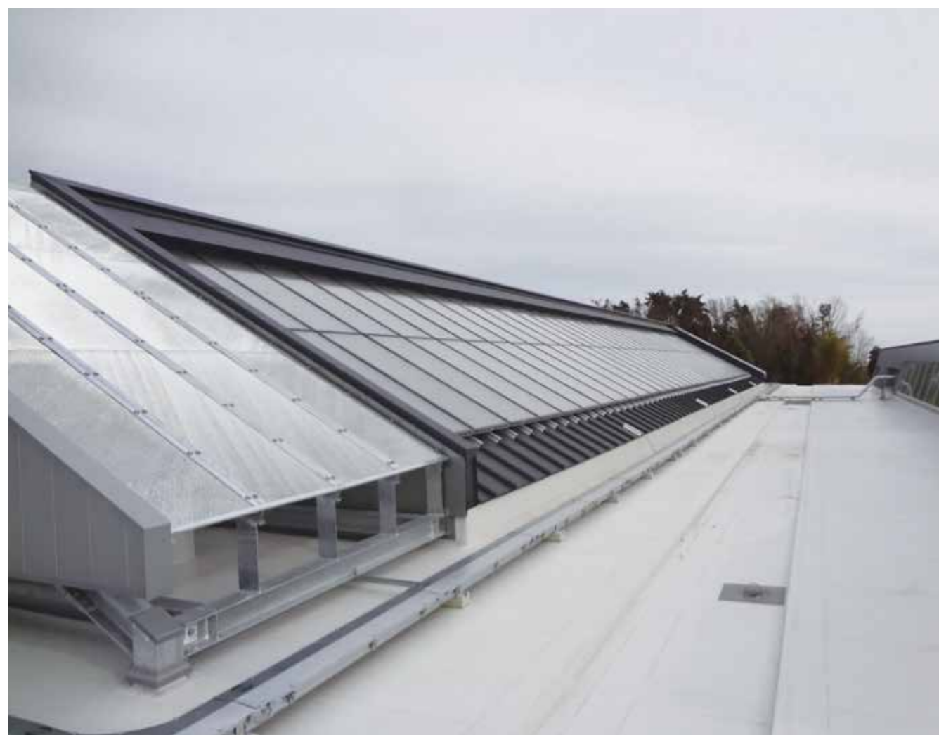
太陽熱空気集熱器(環境配慮型役場庁舎)
