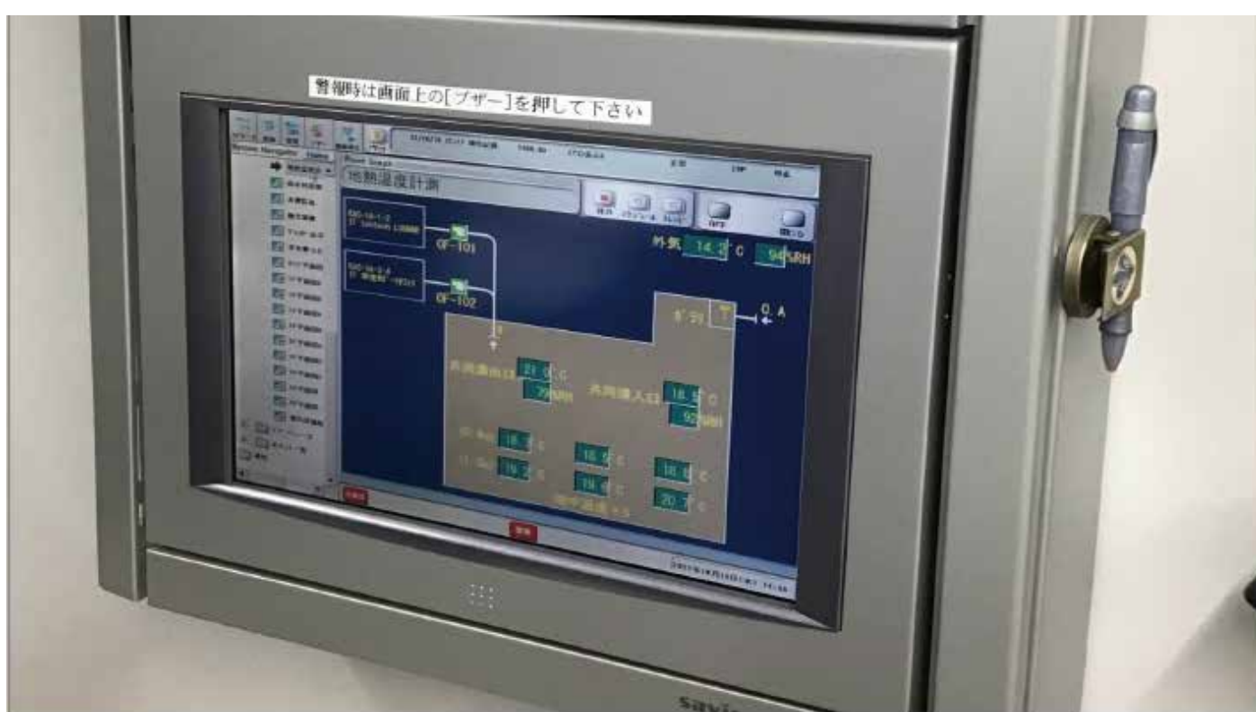
大学建物の中央監視装置
