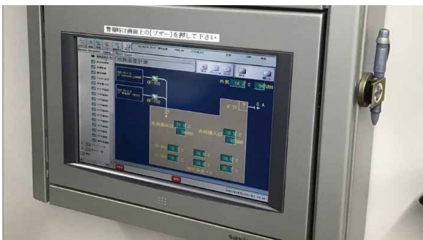
大学建物の中央監視装置
