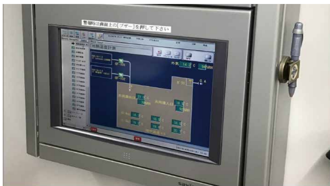
大学建物の中央監視装置
